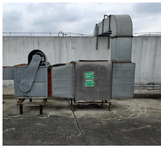
食堂油烟处理设施
