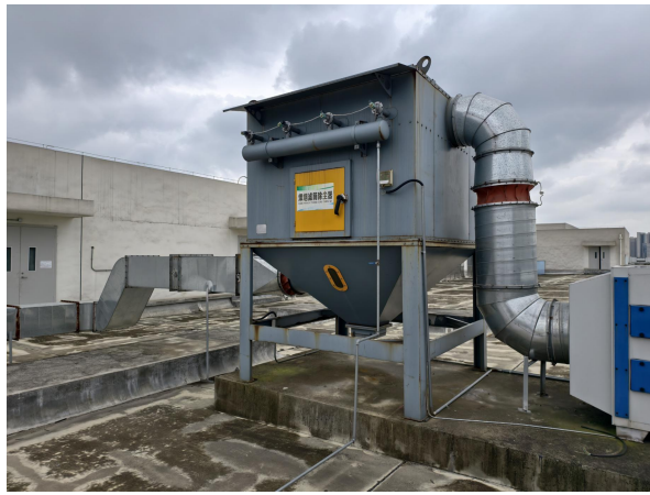
焊接废气处理设施
