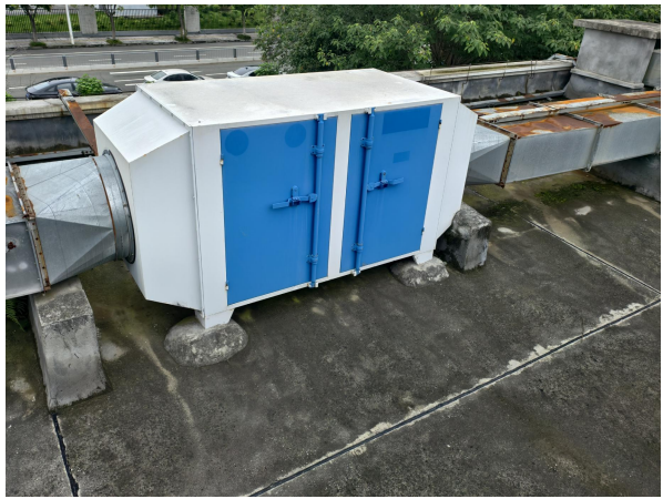
危废间废气处理设施
