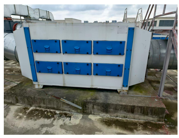
有机废气处理设施
