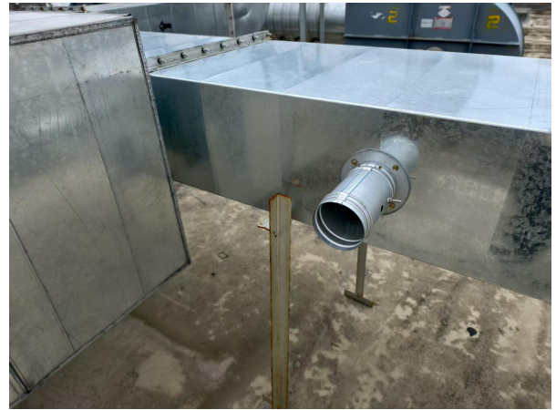
焊接废气监测孔
