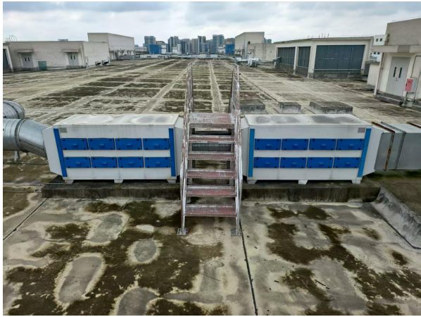
有机废气处理设施
