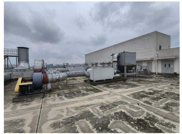
焊接废气处理设施
