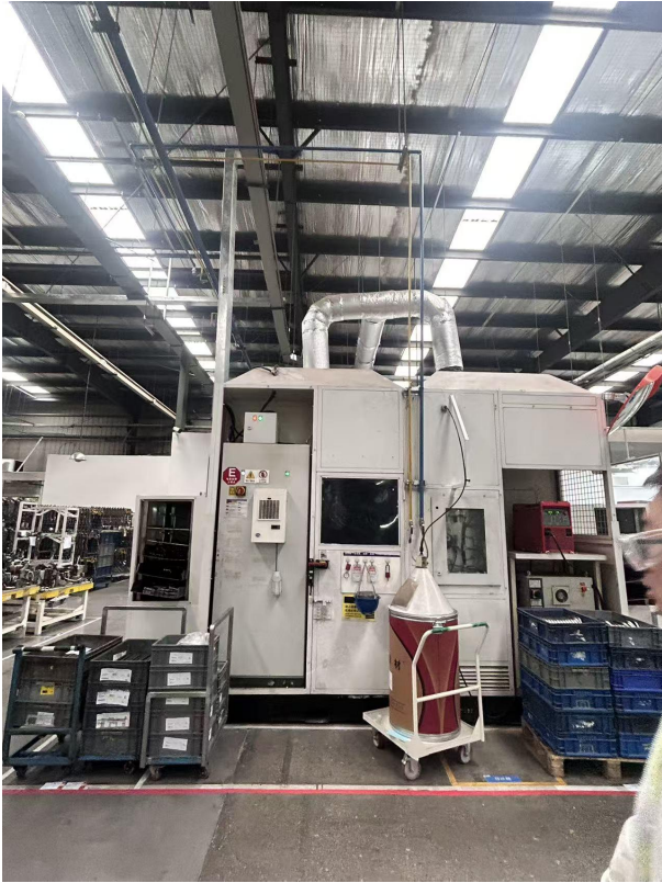
焊接废气收集系统
