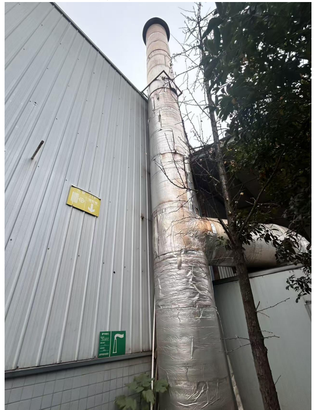
焊接废气处理设施
