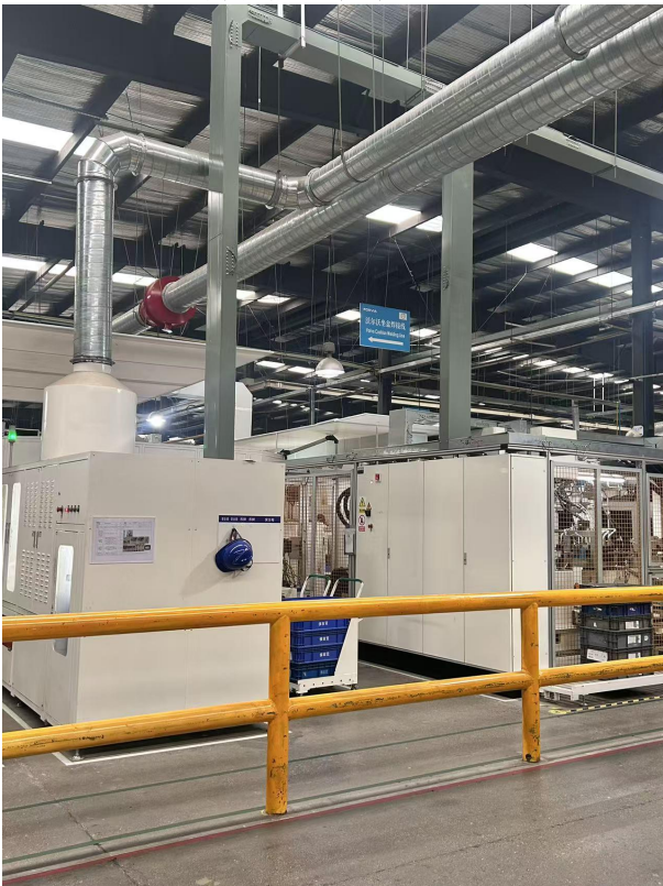
焊接焊废气收集系统
