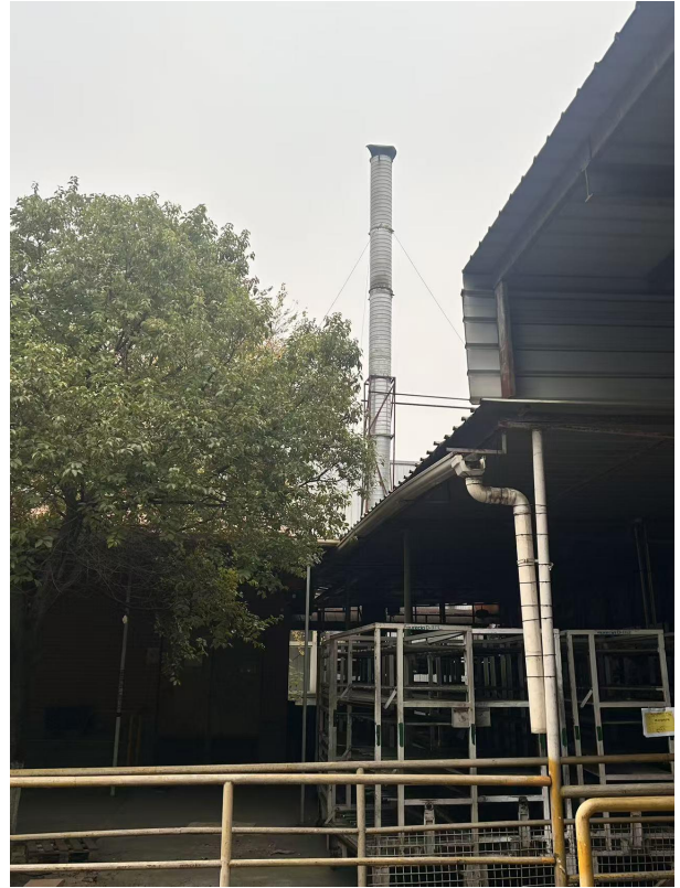
焊接废气处理设施
