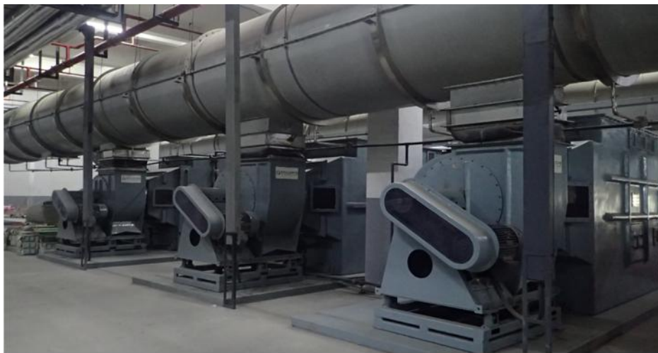
酸性废气处理装置
